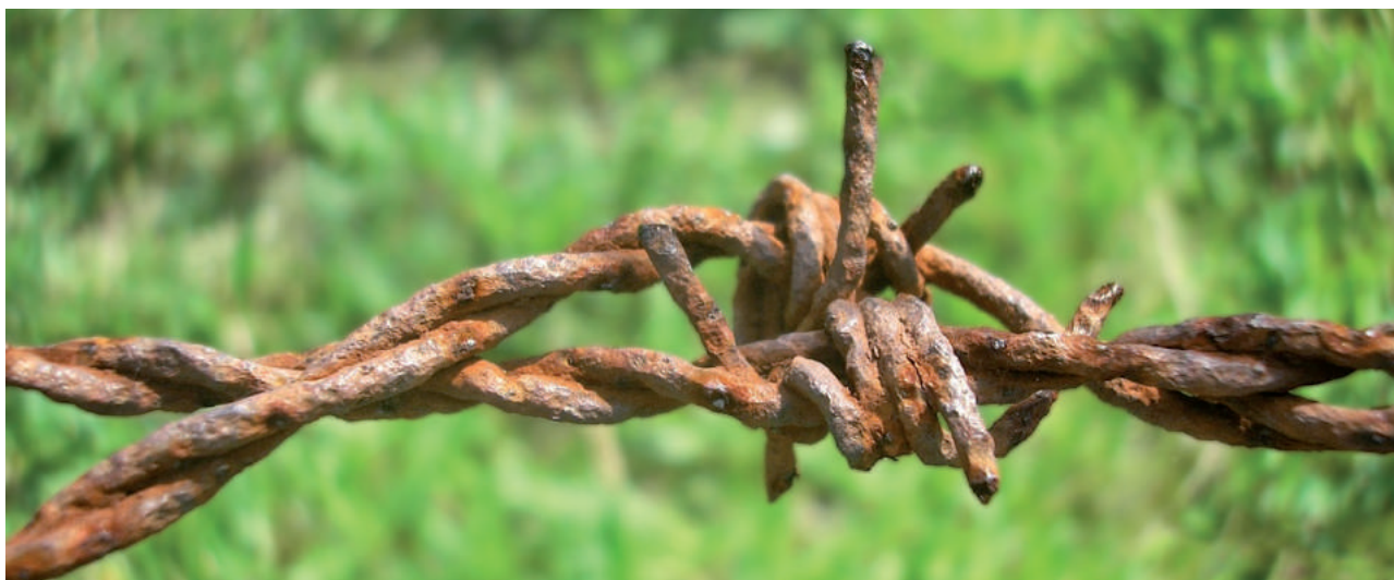
■ Corrosión del hierro
